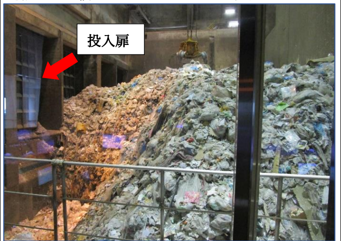
可燃ごみが積み重なったごみピット状況
