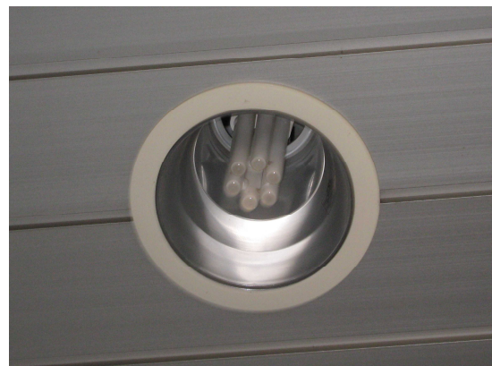
従前の照明器具
