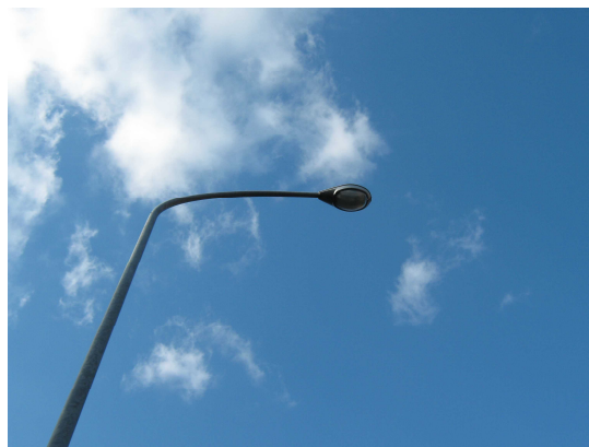
従前の照明器具 (水銀灯)
