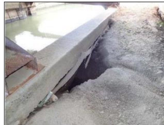
境堀排水路:劣化状況(背面土吸出し)
