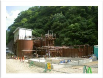
(*)水をきれいにする設備 福井県・河内川ダムの事例
