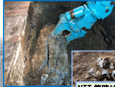
NTT 管路は鉄管です
