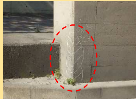
④トンネルの側壁に発生したうき。
