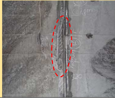
②横断目地付近に生じたうき。監視する。
