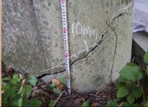
①トンネル入口付近の壁に発生したひび割れ。早期に修理を行うべき破損。
