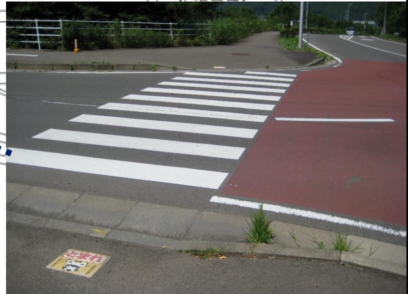
歩道の分離線表示状況
